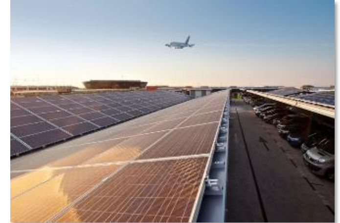
Aéroport de Nice (06) – 1.3MWc
